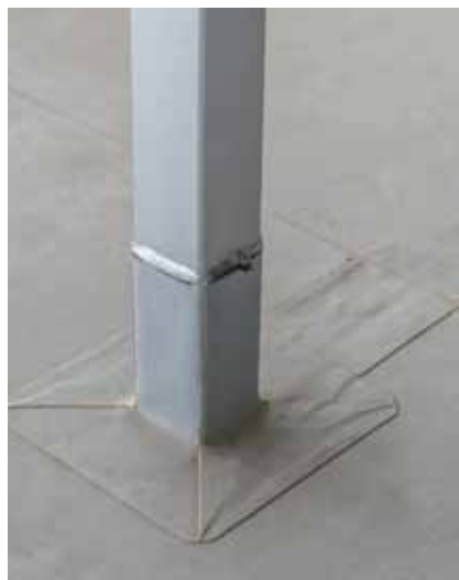
Auf den beiden Kuben war aufgrund der vielen Stützen die Verlegung der Dachabdichtung handwerklich anspruchsvoll.
