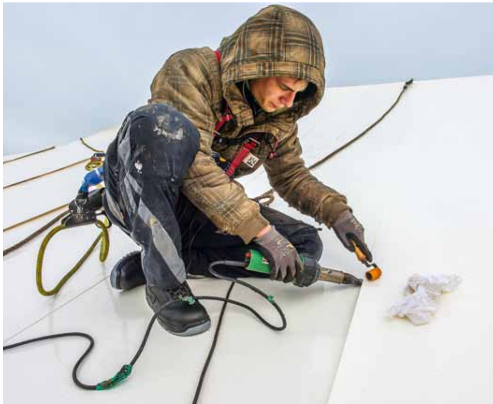
Nahtverschluss per Heißluft: Um die weißen Bahnen nicht schon während der Verlegung zu verschmutzen, wechselten die Dachdecker, die direkt auf der Abdichtung arbeiteten, extra die Schuhe.
