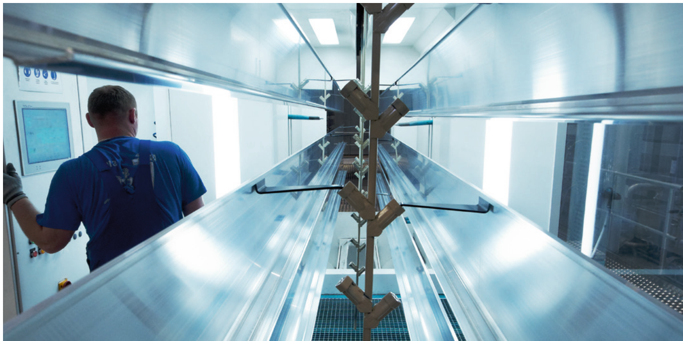
Cabine de revêtement par poudre automatique
